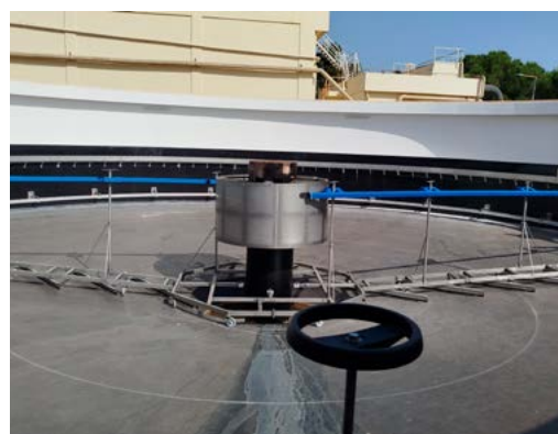
Un equip rascador Manowar (patentat per Tecnoconverting), instal·lat en una depuradora a Portugal.
