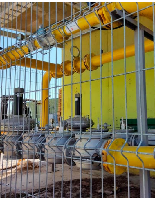
Foto 1. Estació de regulació i mesura per a un cabal màxim de 600 Nm³/h. Pe = 150 mbar. Ps = 50 mbar.
