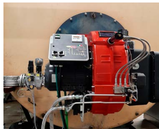
Foto 3. Cremador mixt de gasoil i gas natural de potència màxima de 5.900 kW, per a una caldera de vapor.
