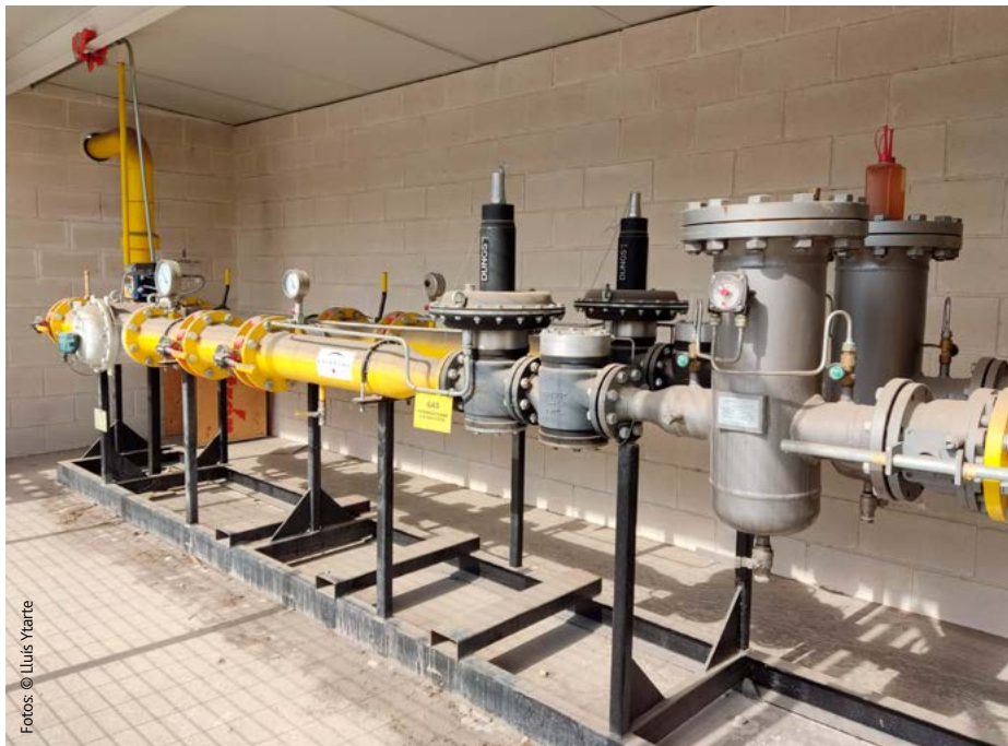
Foto 2. Estació de regulació i mesura per a un cabal màxim de 2.500 Nm³/h. Pe = 16-3 bar. Ps = 1,5 bar.
