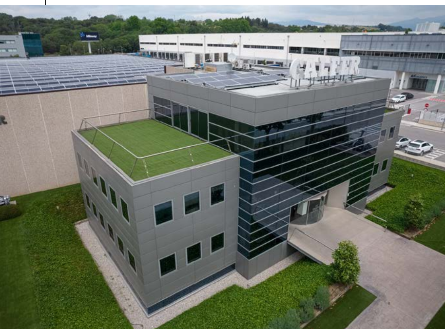
Instal·lació fotovoltaïca a l'empresa de fabricació de frens de competició de motos i bicicletes Galfer, instal·lades per 1komma5°.
