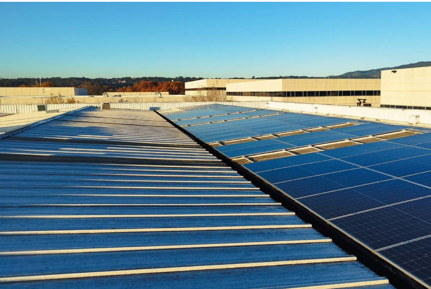
La instal·lació fotovoltaica s'ha fet a la coberta d'una nau.
