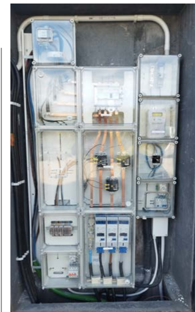
Instal·lació d'enllaç adaptada per acollir el comptador de generació amb una TMF-10 de 160 A per a la instal·lació fotovoltaica i una TMF1 reduïda per al consum de la nau industrial.
