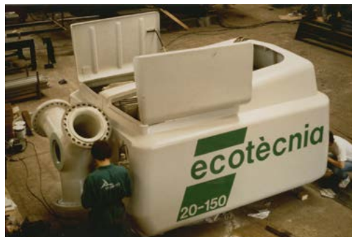
▲ Muntatge de la gòndola d'un aerogenerador 20/150, a principis dels noranta. La carcassa dissenyada per Jordi Mañà disposa de dues portes practicables.
