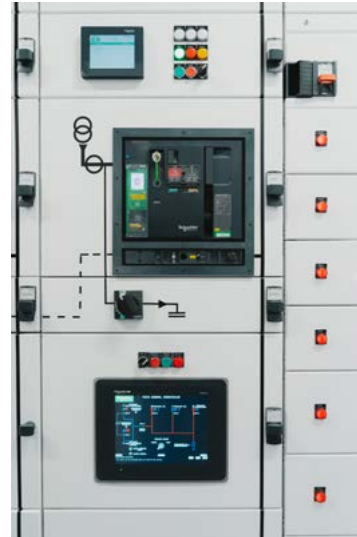
El Building Management System controla la gestió de les instal·lacions.
