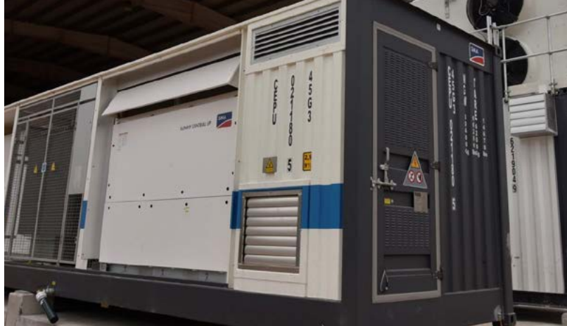
Instal·lacions de la planta de Lloseta (Mallorca).
