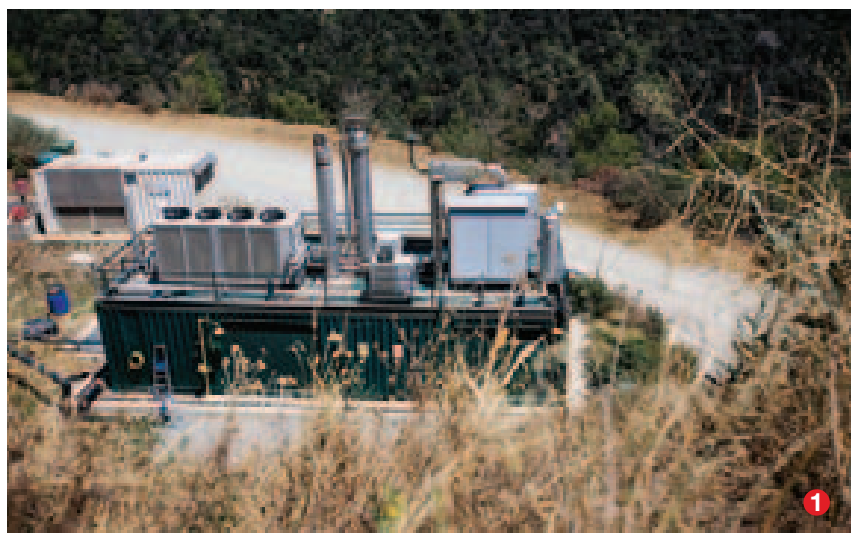
1 Pla picat de la planta de biogàs, on s'aprecien la unitat de tractament de gas, la microturbina, el recuperador de calor i els equips auxiliars instal·lats en la part superior de la planta.
