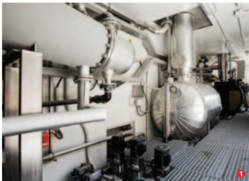
1 Zona de regeneració de l'absorbent ( reboiler , torre de destil·lació, caldera i bescanviadors), 2 La microturbina i el recuperador de calor, entre altres equips, s'han instal·lat al sostre.
