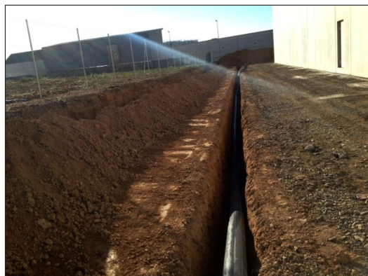
Colector de alimentación enterrado en polietileno.
