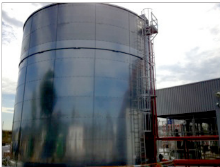
Fotos de depósito de tipo A, de chapa de acero galvanizado.
