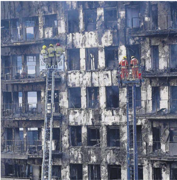
Bomberos valencianos y de la UME inspeccionan, ayer, el edificio devorado por las llamas en València.
